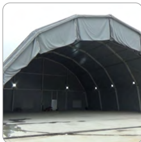
电动提升门机库
